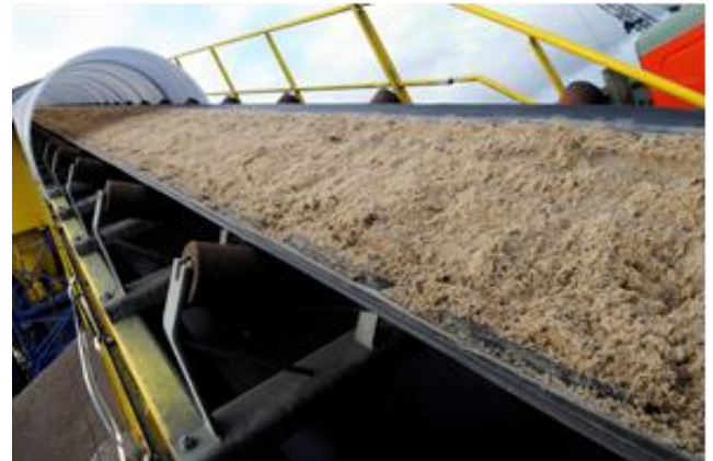
Les tambours et les stations mal alignées peuvent causer une usure supplémentaire
