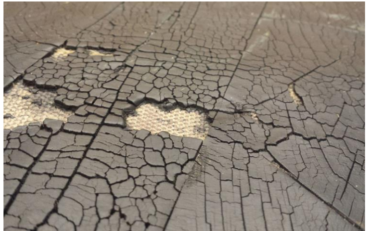
Los efectos del daño por calor
