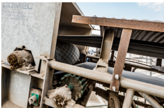
Las grietas transversales se profundizan bajo la tensión repetida del paso sobre las poleas y los tambores.
